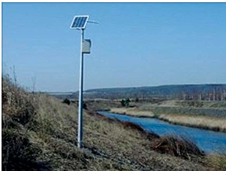
Рисунок 4.25 – Пример размещения оборудования пункта наблюдения на мачте
